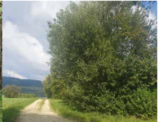
Weg Nr. 7, ungenügende Entwässerung
